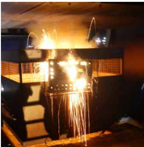
STROMBRAND AN EINER SCHALTAFEL DIE AN EINEM KOFFER-TRANSPORTBEHÄLTER BEFESTIGT WURDE. EIN STOCKWERK HÖHER BEFINDET SICH DIE BORDKÜCHE DES ÜBUNGSFLUGZEUGES DIE BEI SCHULUNGEN FERNGESTEUERT IN FLAMMEN AUFGEHEN KANN.
